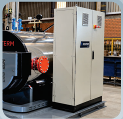
Vista do quadro elétrico
