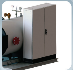
Vista do quadro elétrico
